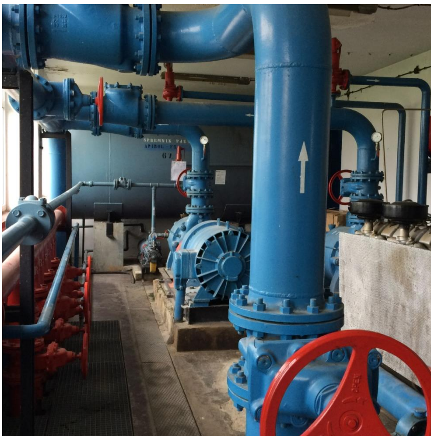
Slika 53. Vatrogasna pumpaonica i spremnik pjenila
